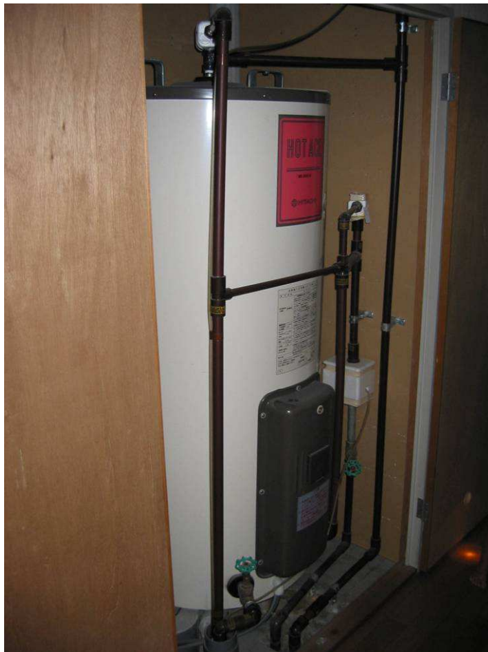
電気温水器全体
